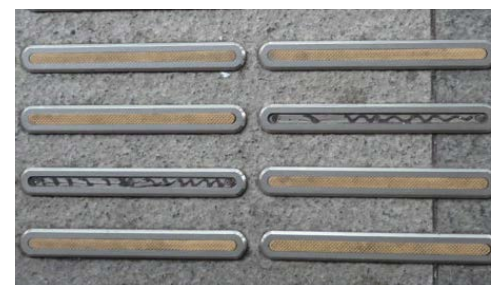
補修前の不具合
