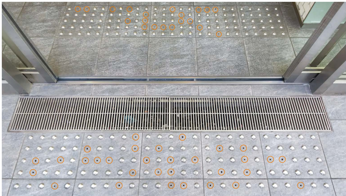
鋏の脱落箇所
